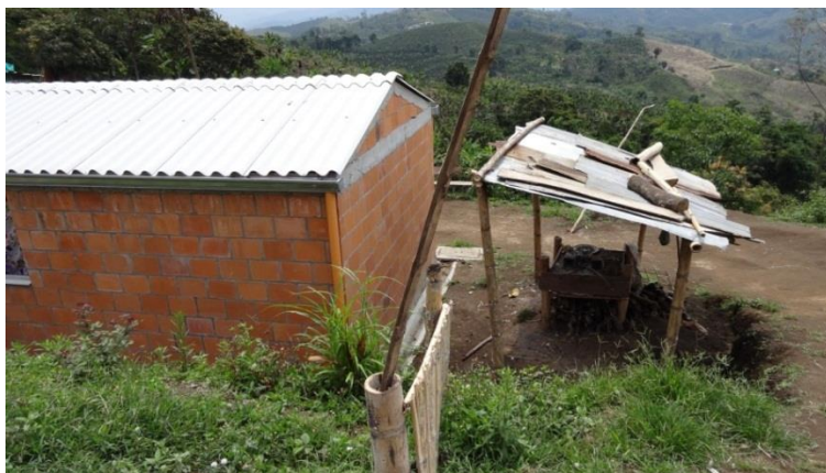
Foto 28. Cocinas construidas de forma artesanal con cubierta. Plan de vivienda. 2017
