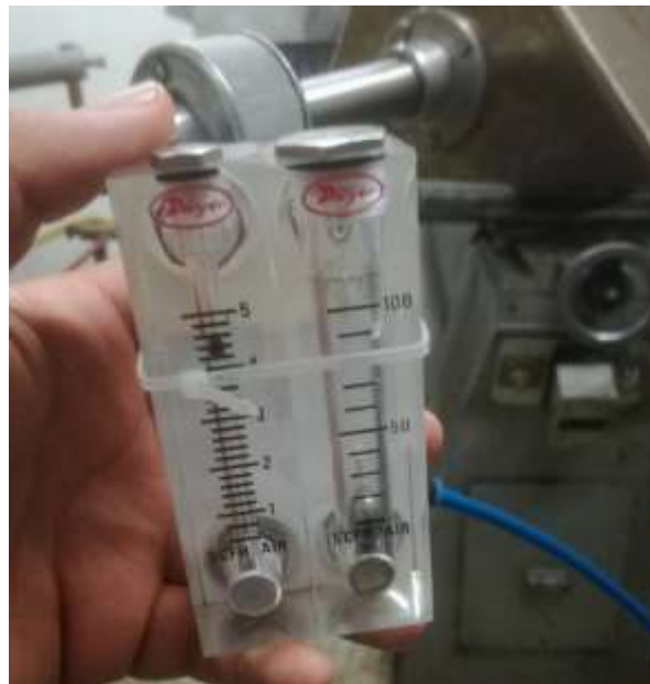
Figura 3. Medición del caudal de gas
