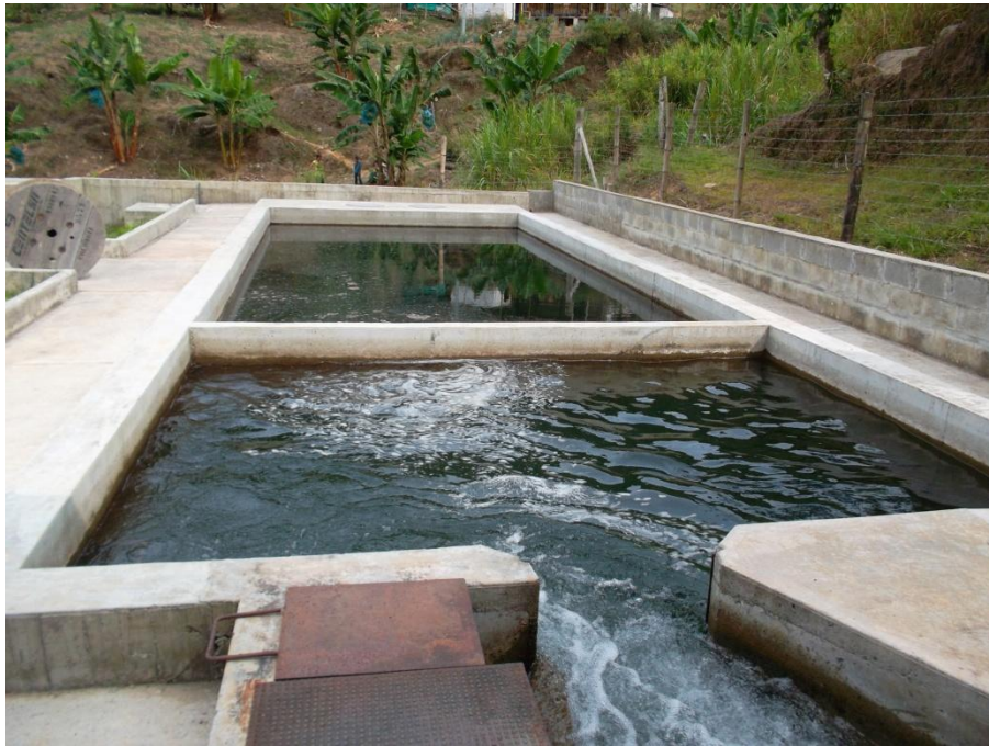
Imagen No. 10: Tanques del acueducto municipal de Belén de Umbría. Fuente: Construcción propia. 2013
