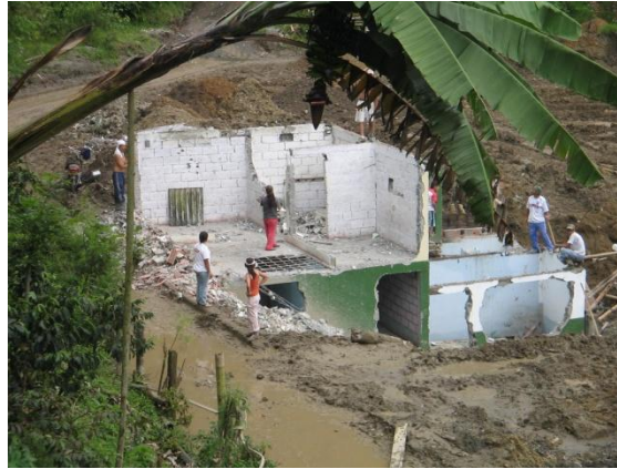
Figura 36. Vivienda demolida por sus propietarios en el barrio La Playita.
