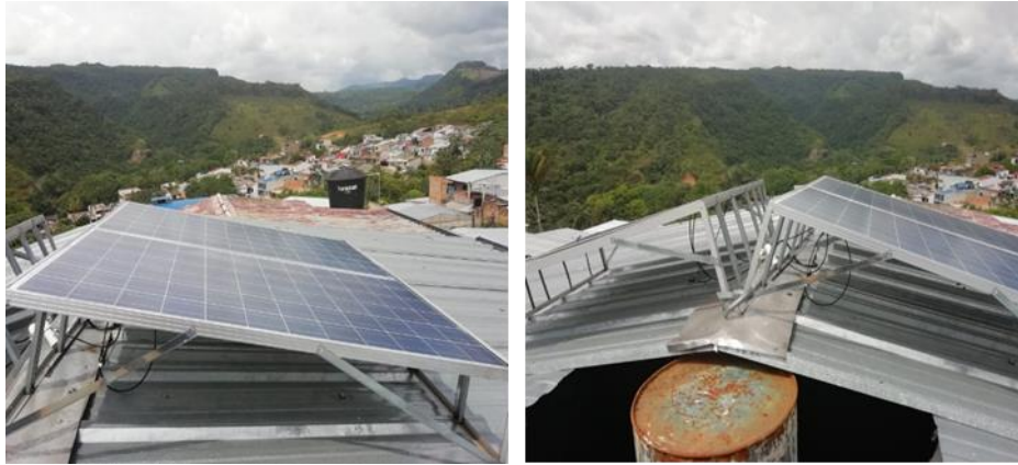
Fotografía 6. Sistema solar fotovoltaico Casa residencial barrio Sinaí – Florencia
