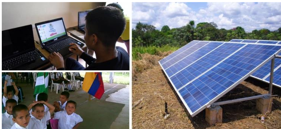
Figura 1. Paneles solares en Caquetá, financiado por la Embajada de Turquía
