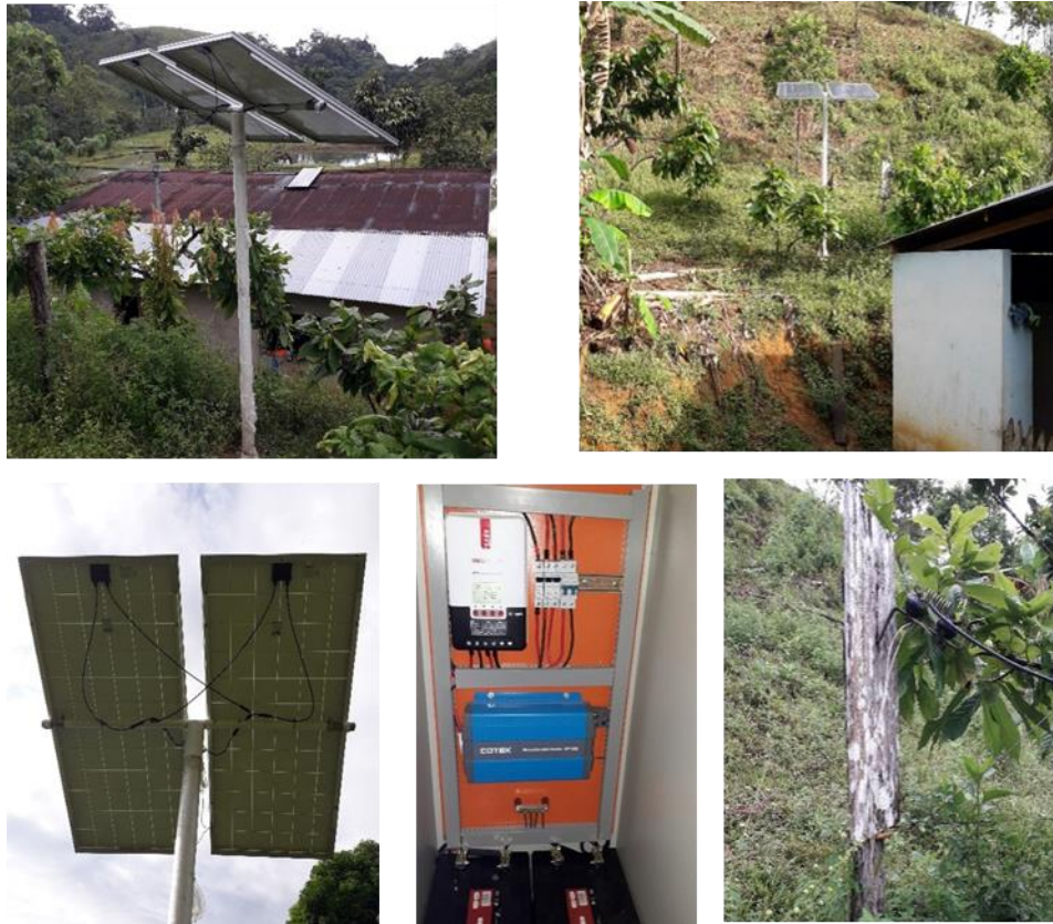
Fotografía 4. Sistema solar fotovoltaico Finca El Charco - San José del Fragua
