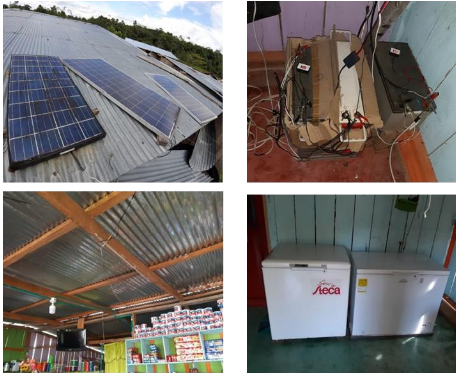
Fotografía 5. Sistema solar fotovoltaico en la vereda Puerto Mercedes – Solano
