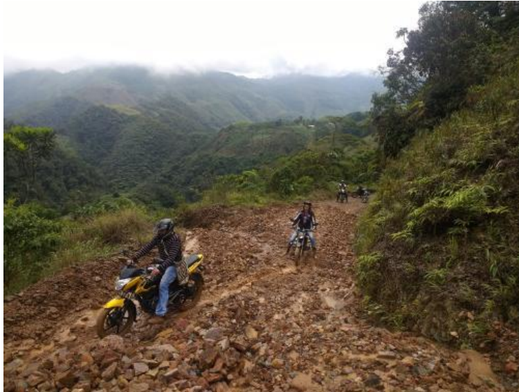
Figura 33 Tramos en las vías rurales afectados por deslizamientos
