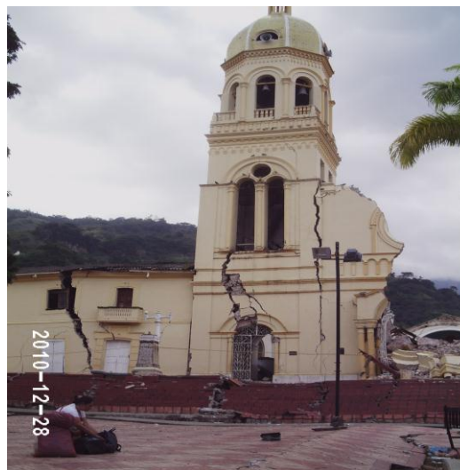
Foto 4. Iglesia principal colapsada.
