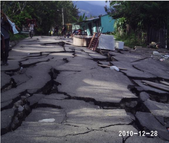
Foto 7. Afectación suelo urbano.
