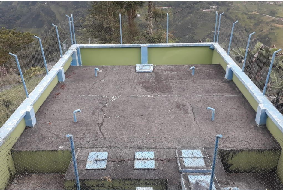
Figura 34. Tanque de almacenamiento
