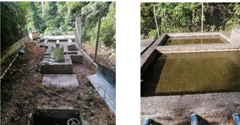
Figura 28. Sistema de filtración de múltiples etapas
