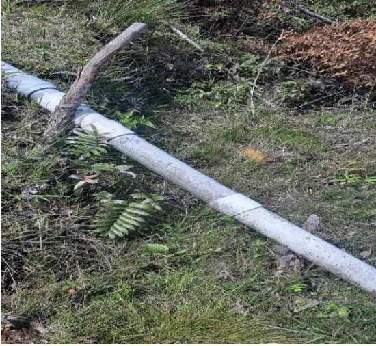
Figura 21 Tubería en la bocatoma
