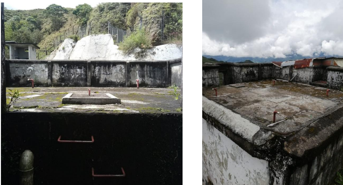
Figura 25. Tanques de almacenamiento
