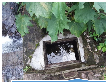
Cámara de captación
