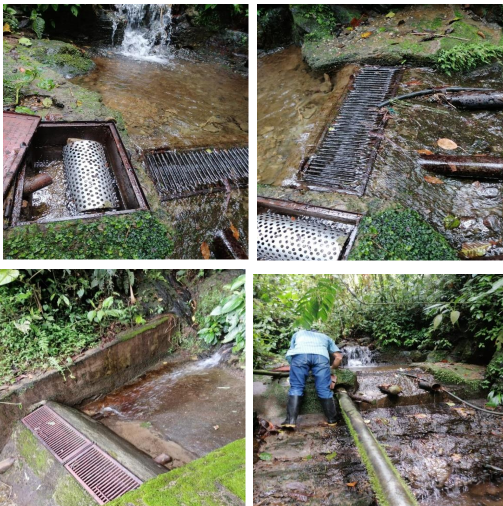
Figura 23. Sistema de captación de agua
