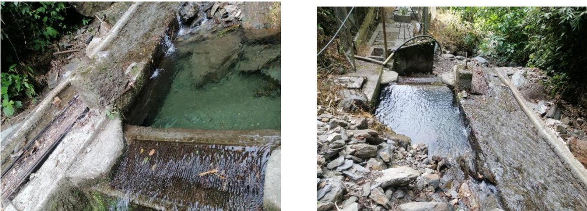
Figura 27. Sistema de captación
