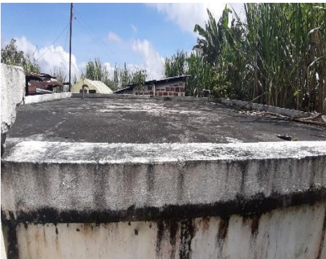
Figura 22. Tanques de almacenamiento
